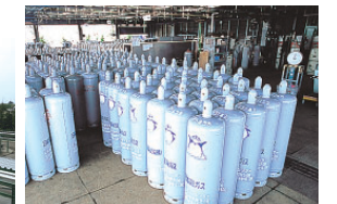
LPガス充填所
