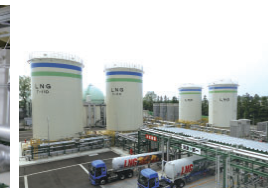
LNGサテライト
