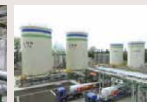
LNG サテライト
