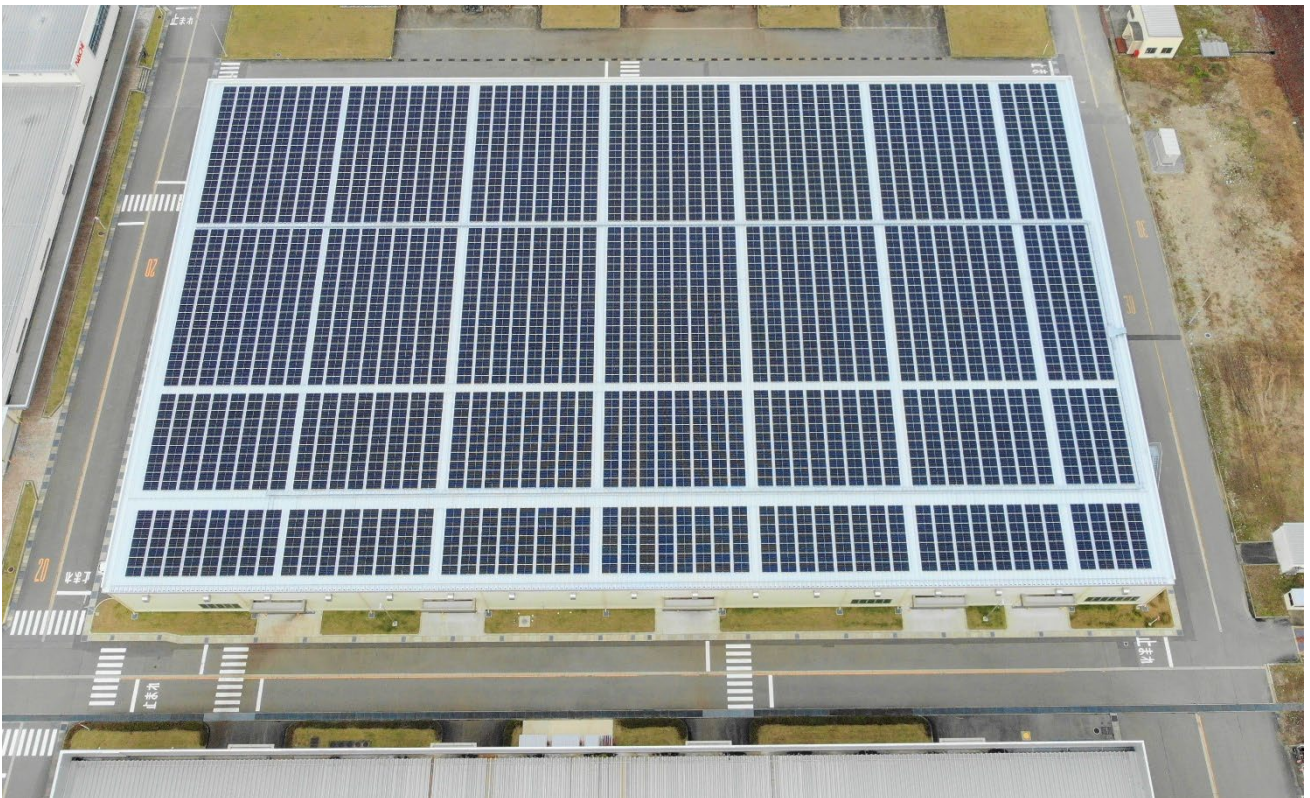
自家消費型太陽光発電システム（不二越 滑川事業所 油圧モータ第2工場）
