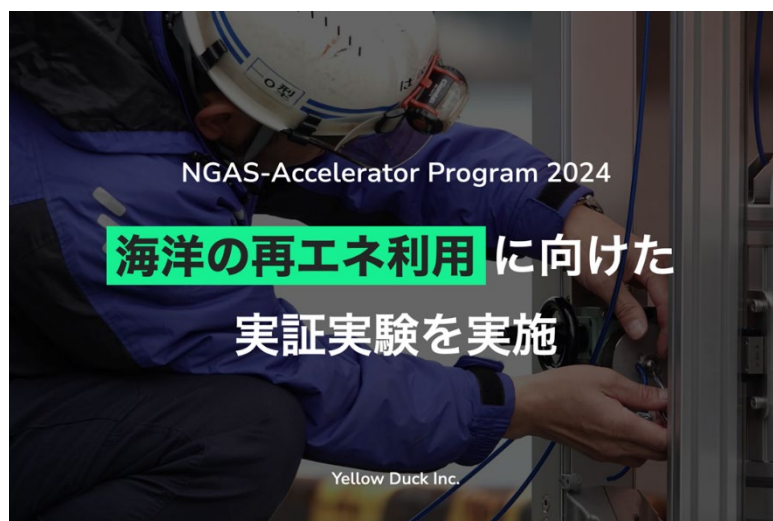
実証機器の設置の様子
