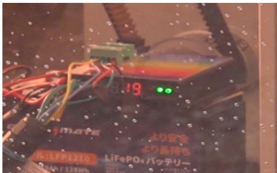
雨天時に発電している様子
